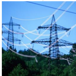
کابل‌های هوایی (Overhead)
